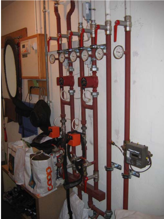
Ungedämmte Heizungs- und Warmwasserrohre verursachen grosse Wärmeverluste – welche einfach verhindert werden könnten. Bild Franz Ulrich.
